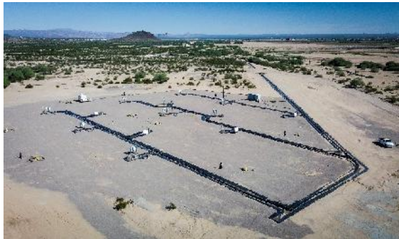
Erste Laugungsanlage (taseko)
