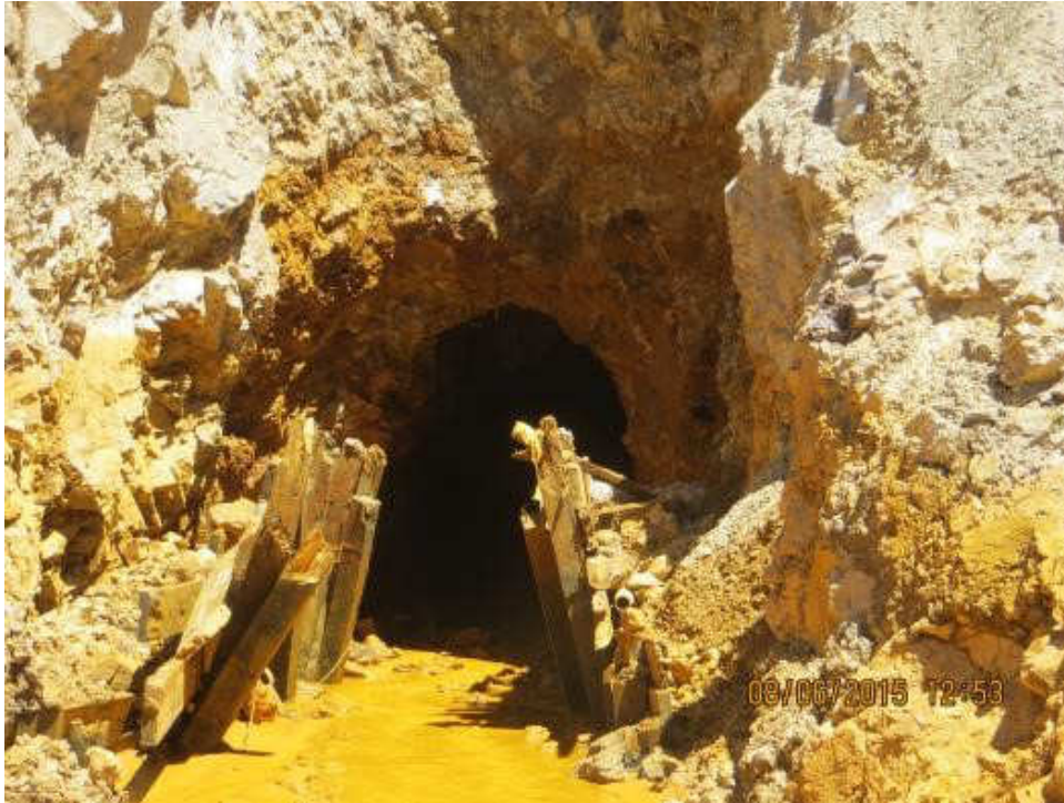
Mundloch des Stollens nach dem Wasserdurchbruch
