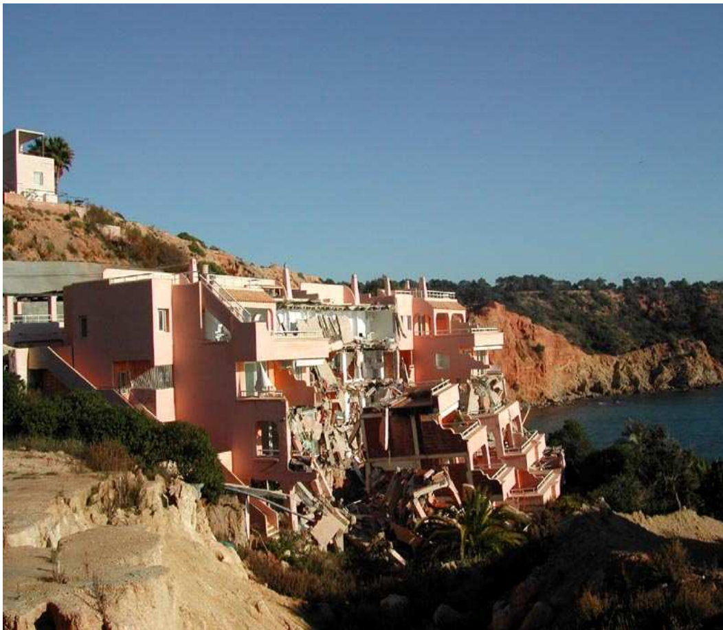
Abb. 7 : Durch Hangrutschung zerstörte Wohnanlage in Vista Alegre
